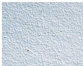
Dažyto paviršiaus defektas
