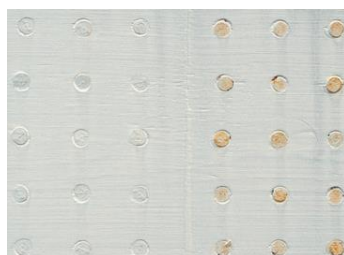
Dažyto paviršiaus defektas
